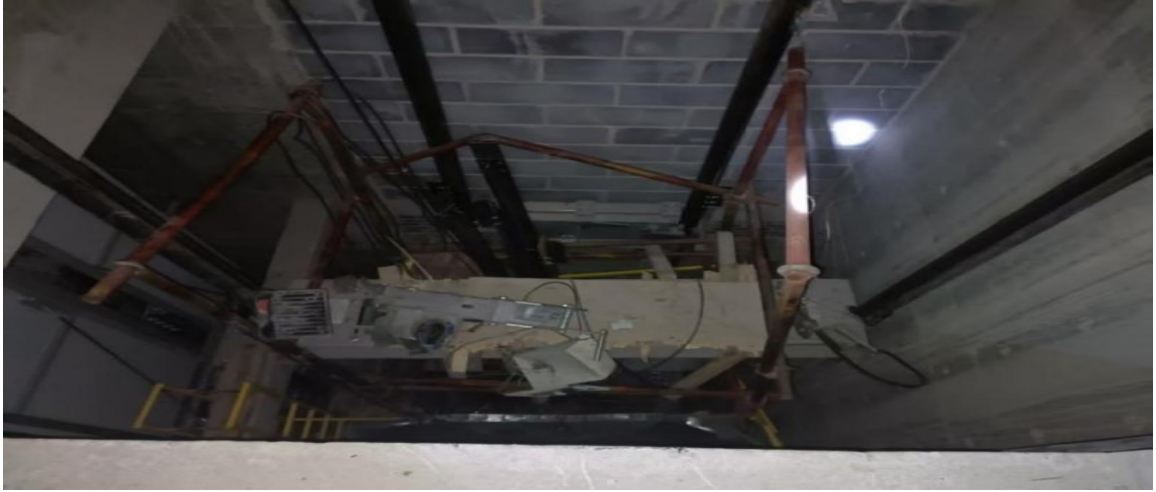
图 1 事故现场情况
