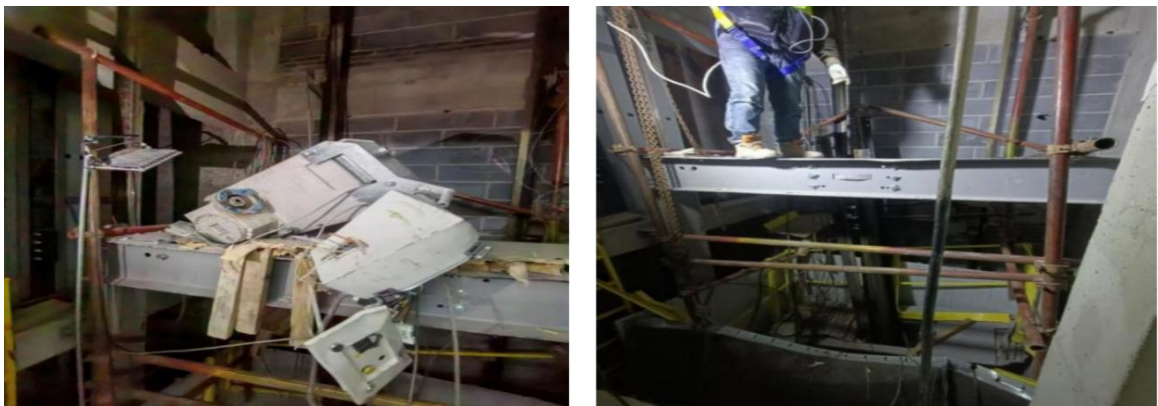
图 2 轿厢、载人提升设备、脚手架、照明等坠落后情况
